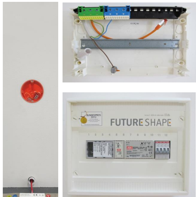
Bild 5: Variante B mit Anschlussdose (links) und SensFloor-Netzteil und Schaltern im Schaltkasten (rechts). Das Leerrohr im Schaltkasten führt zur Anschlussdose. 230/110VAC und Netzwerk-Anschluss (hier orange) müssen im Schaltkasten vorhanden sein. Rechts unten ist der fertig installierte Schaltkasten abgebildet (Beispiel).
